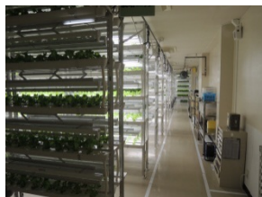
クリーンルームをリノベーションした植物工場の室内
