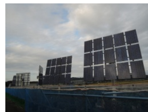
太陽の向きに合わせてパネルが稼働する太陽光発電システム
