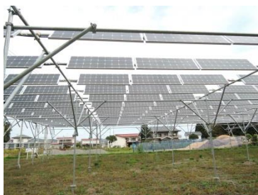
■営農型太陽光発電施設
