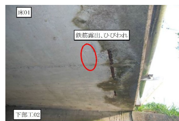
床版下面鉄筋露出 (平成22年度 (震災前) 撮影)
