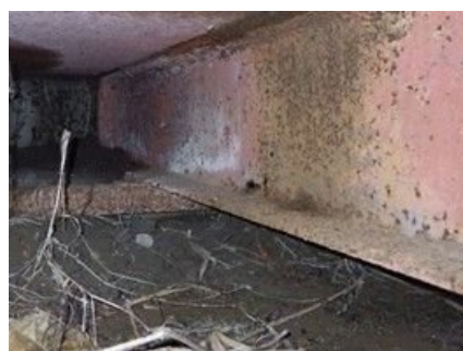
41. 野竹内2号橋：鋼H桁橋 (橋長：8.02m、1965年竣工) 主桁下フランジ・ウェブの腐食 ※下フランジ・ウェブの著しい腐食により、耐荷力の低下が推測される。 (迂回路有り) (特定帰還居住区域)
