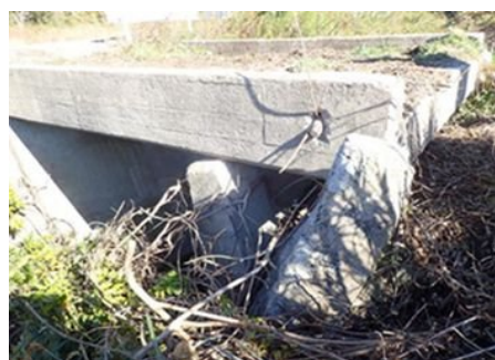
42. 野竹内3号橋：RC床版橋 (橋長：4.27m、1965年竣工) 下部工の沈下・傾斜 ※下部工の沈下及び傾斜により、鉛直支持機能を喪失している。 (現在通行止め) (特定帰還居住区域)
