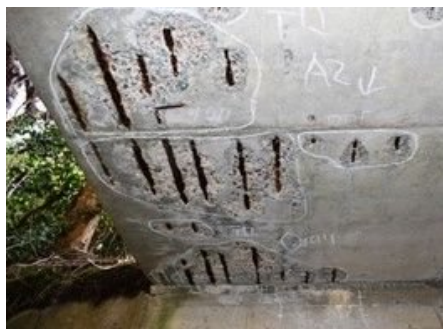
16. 観音堂2号橋：RC床版橋 (橋長：3.40m、1973年竣工) 床版下面の露出鉄筋の腐食 ※露出鉄筋の断面減少により、耐荷力の低下が推測される。(迂回路有り) (旧避難指示解除準備区域)
