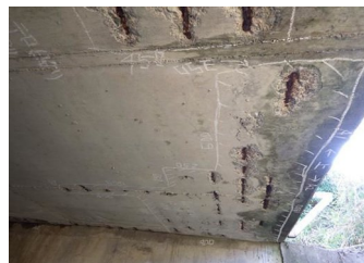
床版下面鉄筋露出 (平成30年度 (震災後7年経過) 撮影)
