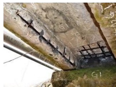
21. 後迫橋：RC桁橋 (橋長：2.50m、1964年竣工) 主桁下面の露出鉄筋の腐食 ※露出鉄筋の断面減少により、耐荷力の低 下が推測される。(迂回路有り) (中間貯蔵施設)
