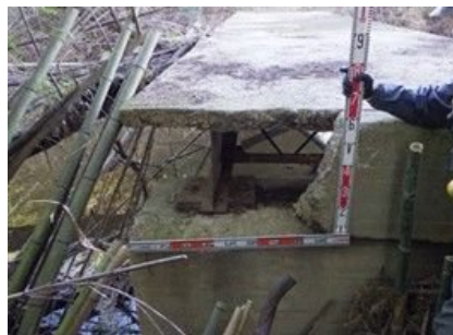
50. 和久前橋：鋼桁橋 (橋長：10.04m、1963年竣工) 橋台パラペットの断面欠損 ※著しく断面欠損しており、部材としての 機能を消失している。 (迂回路有り) (帰還困難区域)
