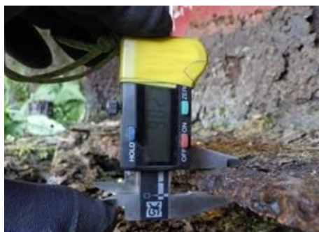
25. 山崎中橋：鋼桁橋 (橋長：8.54m、1983年竣工) 主桁端部ウェブ・下フランジの腐食 ※支点上での板厚減少により、耐荷力の低 下が推測される。(迂回路有り) (帰還困難区域)
