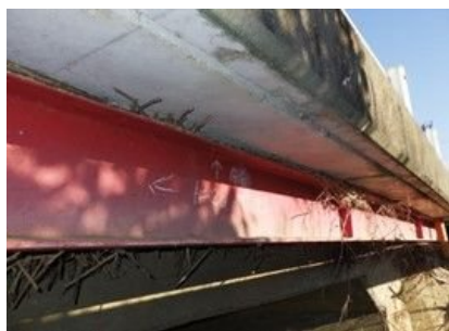
04. 入道淵橋：鋼桁橋 (橋長：10.56m、1960年竣工) 主桁スラブアンカーの破断 ※アンカーの破断による床版との分離によ り、荷重伝達機能の低下が推測される。 (迂回路有り) (帰還困難区域)
