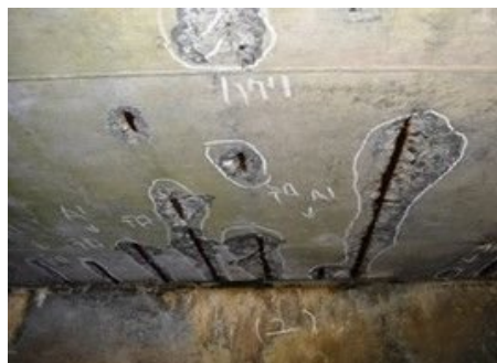
11. 北観音堂橋：RC床版橋 (橋長：3.55m、1973年竣工) 床版下面の露出鉄筋の腐食 ※露出鉄筋の断面減少により、耐荷力の低下が推測される。(迂回路有り) (旧避難指示解除準備区域)
