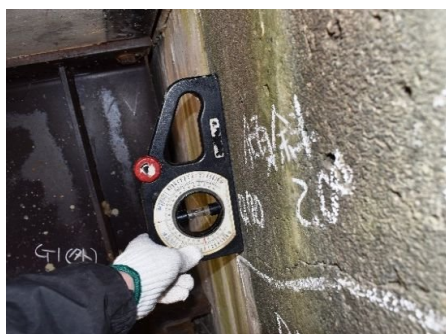
88. 岩ノ迫橋：鋼桁橋 (橋長：15.10m、1991年竣工) 橋台パラペットの欠損、傾斜 ※パラペット付け根の壊れにより、背面土 土留め機能の低下が推測される。 (迂回路有り) (帰還困難区域)
