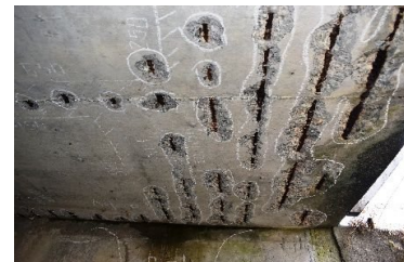
床版下面鉄筋露出 (令和4年度 (震災後11年経過) 撮影)
