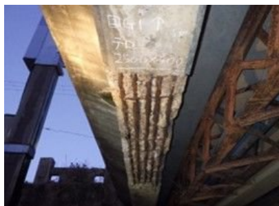
65. 戎川橋：RC T桁橋 (橋長：18.06m、1932年竣工) 主桁下面の露出鉄筋の腐食、 下部工の斜めひびわれ ※露出鉄筋の断面減少により、耐荷力が低下している。(迂回路有り) (旧特定復興再生拠点区域)
