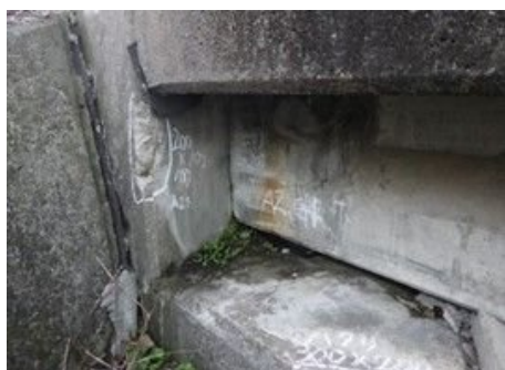
12. 郡代橋：プレキャスト桁橋 (橋長：11.80m、1979年竣工) 横桁PC定着部の錆汁を伴った漏水 ※内部鋼材の腐食の進行は、耐荷力の低下に 影響する。(迂回路有り) (特定帰還居住区域)
