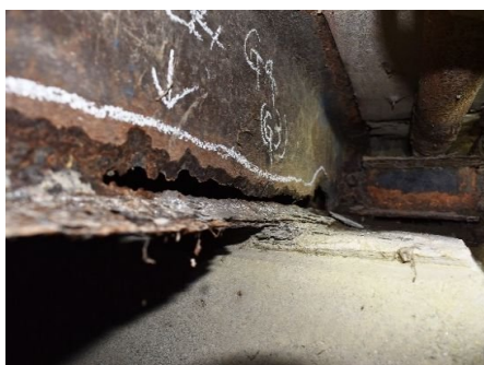
08. 西郷内橋：鋼H桁橋 (橋長：7.50m、1970年竣工) 主桁下フランジ・ウェブの腐食 ※桁端部の断面欠損及び孔食により、耐荷力が低下している。 (迂回路有り) (旧特定復興再生拠点区域)
