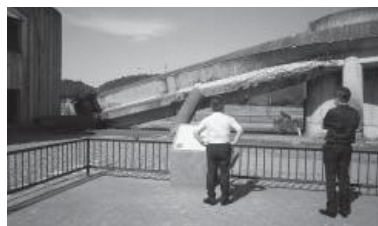
③ 鉄筋コンクリート通路のねじれ
