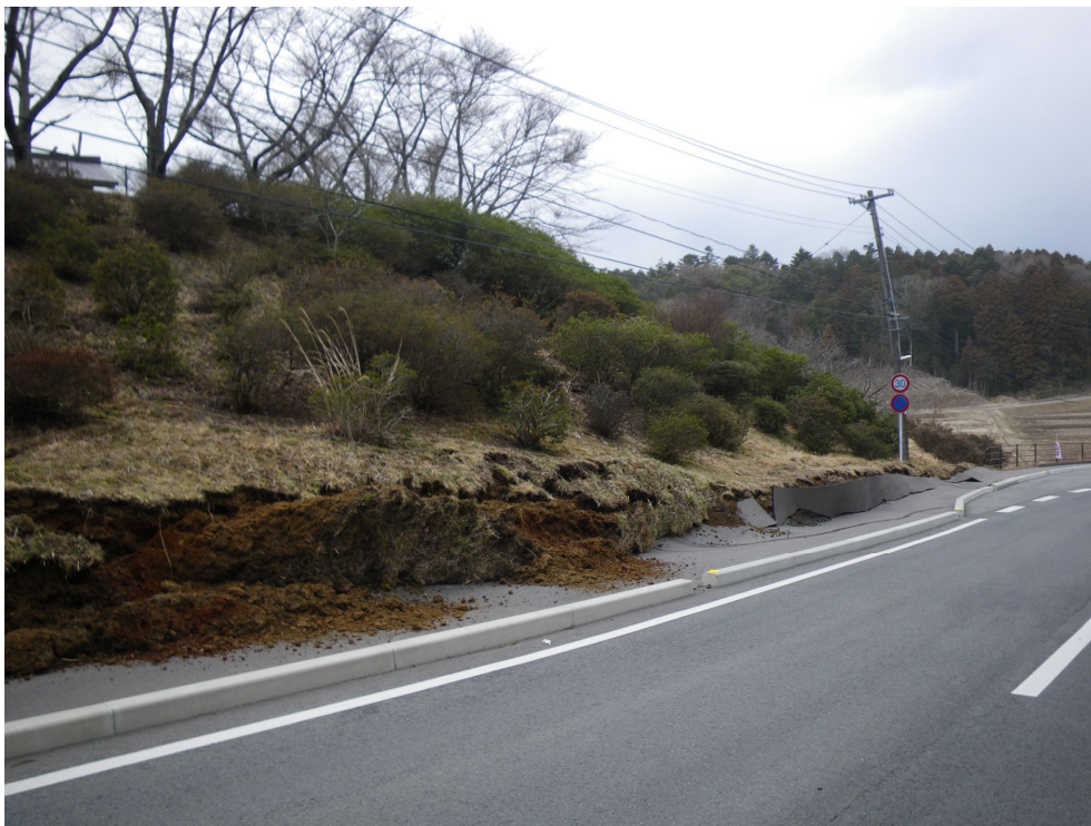
写真 10：震災直後の双葉中学校グランドの斜面崩壊状況。2011. 3. 11
