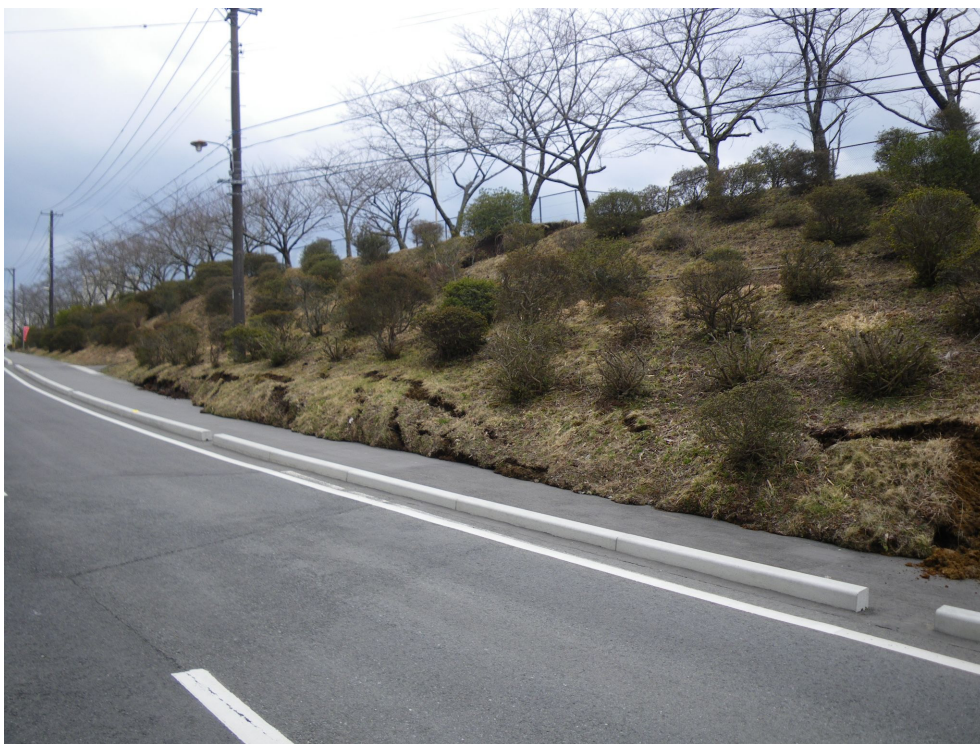
写真 8：震災直後の双葉中学校グラウンドの斜面崩壊状況。2011. 3. 11
