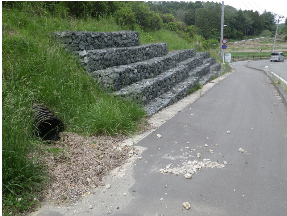
写真 2：枯草等の流出はあるが、新たな土砂流出は確認されない。
