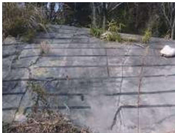
第9-1図 剥がれた防水シート
