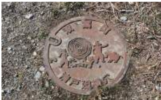
第4-1図 マンホール
