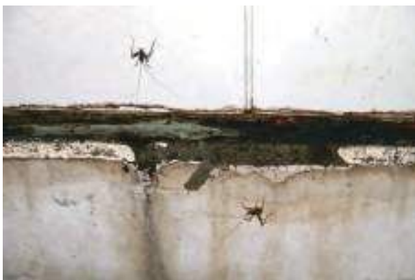
第3-51図 巾木の劣化状況
