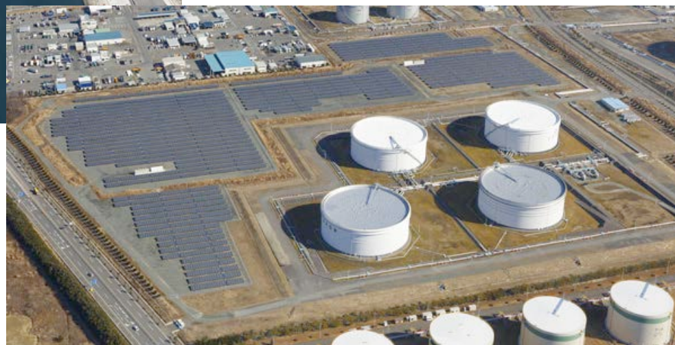
小名浜・泉ソーラー第一／第二発電所（6.2MW）
