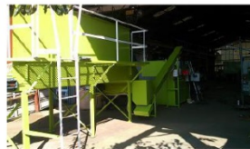
実証用バイオマスボイラ
