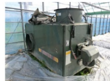
バックアップボイラ
