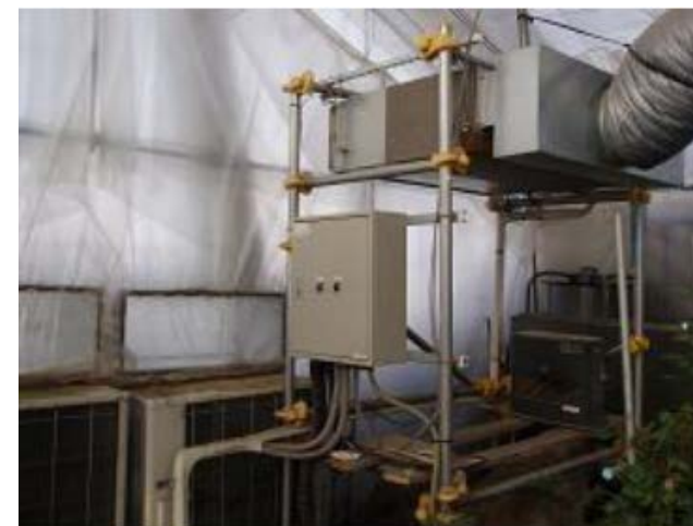
ヒートポンプ（上方に設置）
