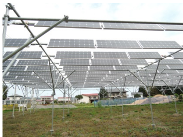
■営農型太陽光発電施設
