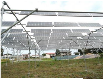
■ 営農型太陽光発電施設
