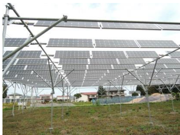
■営農型太陽光発電施設
